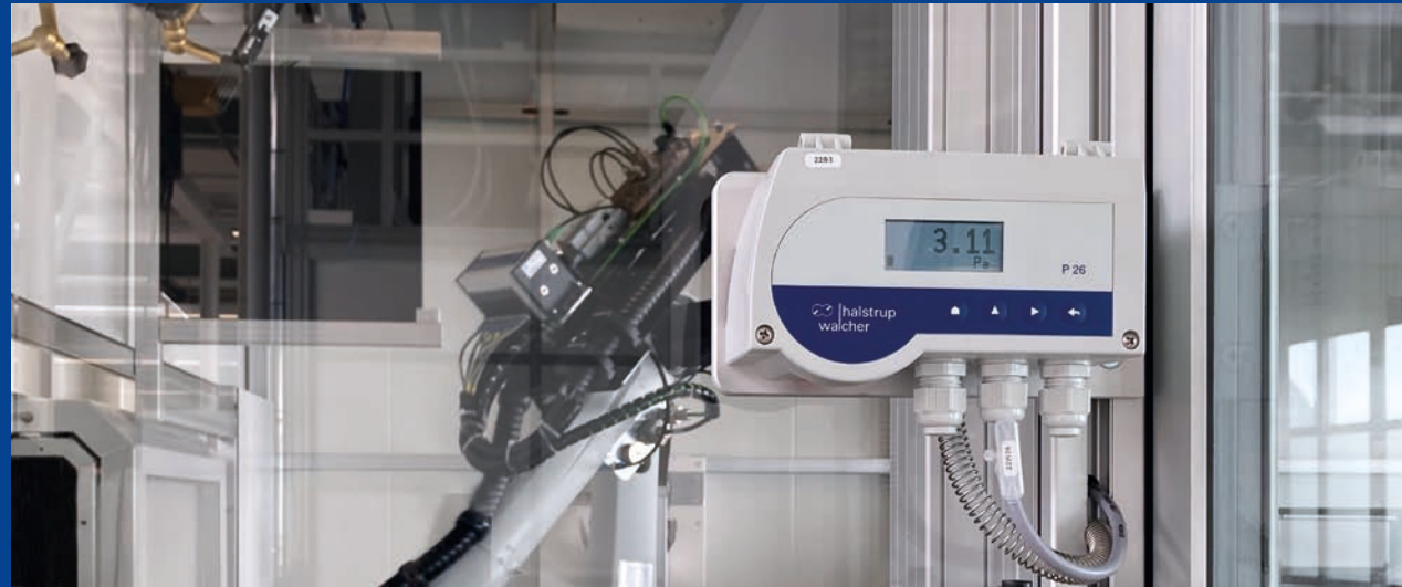
Anwendung eines P 26 zur Überwachung und Steuerung der Schutzbarriere in der aseptischen Produktion von Impfstoffen.
